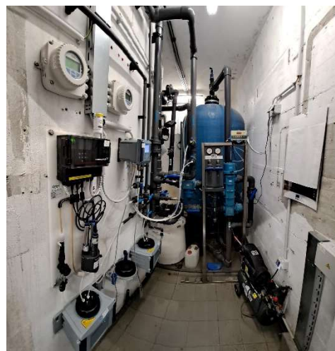
Slika 2: Merilna oprema in filter (eden od treh) v vodohranu v Ledinah
